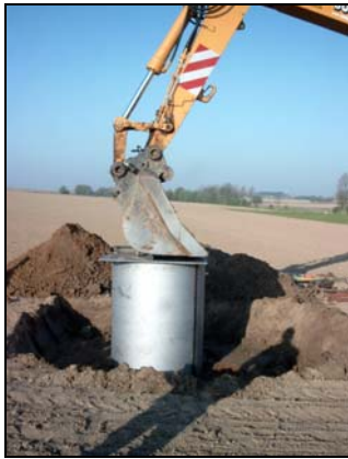
Photo 7 : Dégagement et séparation des premiers horizons de sol ; poussée de la grue sur la plaque acier
